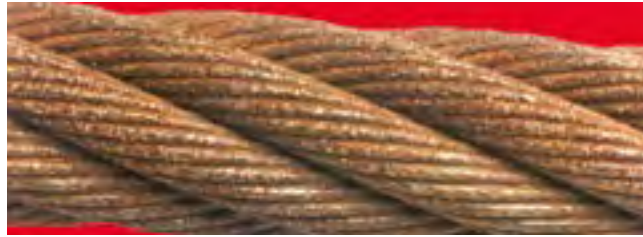
ı. Dış korozyonun yakınlaştırılmış şekli
